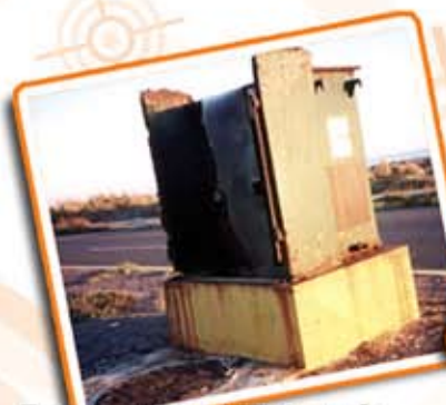
Transformador CFE después de 6 años con protección anticorrosiva convencional.
