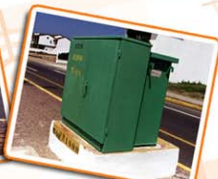
Después de 6 años con protección Metalyzinc® Zn-Al.
